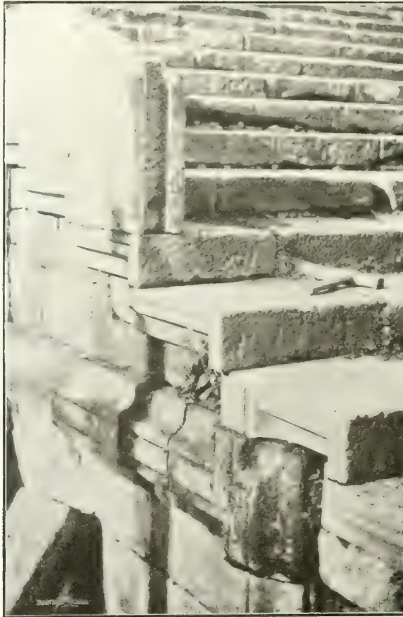
Fig. 12 - Il parapetto con la traccia dell'innorsata.
